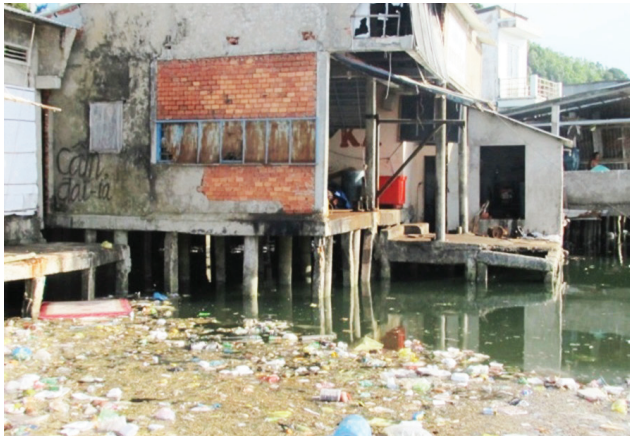
Hệ thống nước thải năm 3/2018
